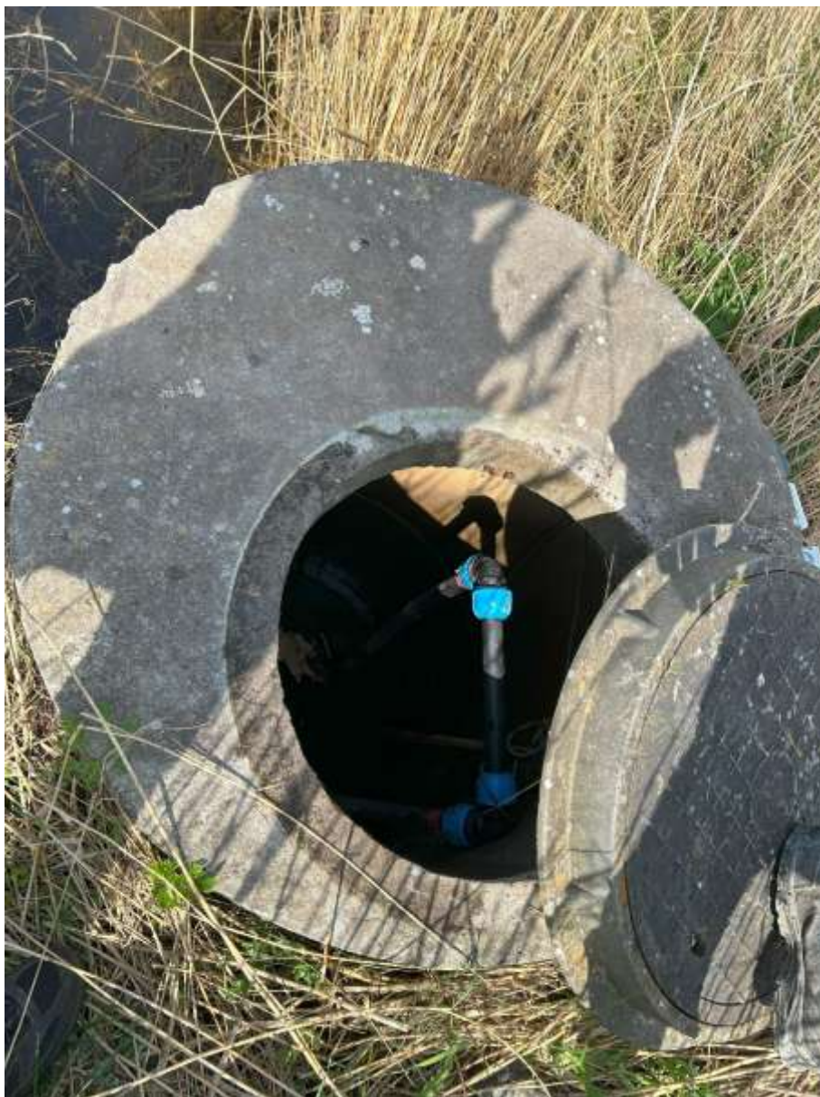
Figur 2-7 Pumpe på Jacob Borups ejendom (pumpe 3 på Figur 2-1). Pumpen er placeret for enden af grøften mellem Jacob Borups og TAMU's marker og modtager således også vand fra TAMU's arealer.
