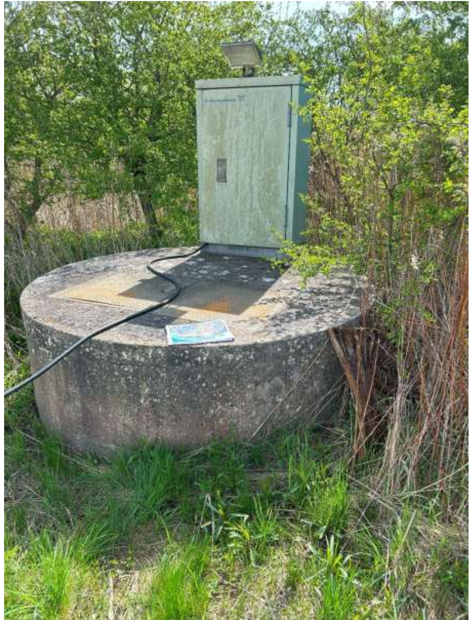
Figur 2-6 Pumpe ved Forsvaret (pumpe 5 på Figur 2-1).
