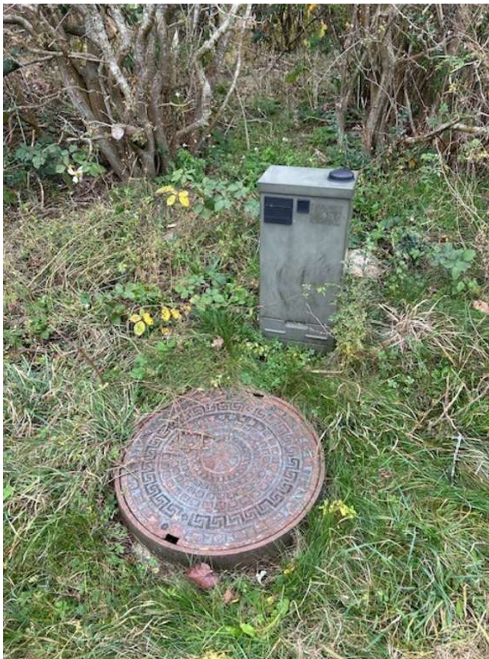
Figur 2-8 Pumpebrønd med tilhørende el-skab syd for Kongelundsfortet. Kapaciteten af pumpen i brønden er ikke kendt.
