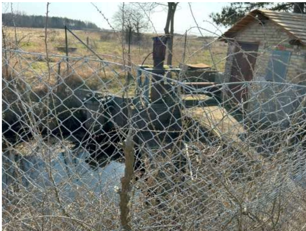
Figur 2-4 Pumpestation i Søndre Skovgrøft (pumpe 2 på Figur 2-1). Pumpestationen er opbygget på samme måde som for Nordre Skovgrøft. Dvs. en pumpekapacitet på forventelig 8000 l/min samt en reservepumpe med en pumpekapacitet på 230-250 l/s. Området var aflåst under besigtigelsen. Pumpen driftes af St. Magleby Fælled Pumpelag.
